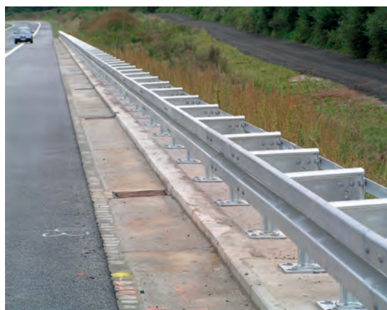
Bild 4: EDSP 1,33 BW auf Fundament in Aufhaltstufe N2 ohne Geländer
