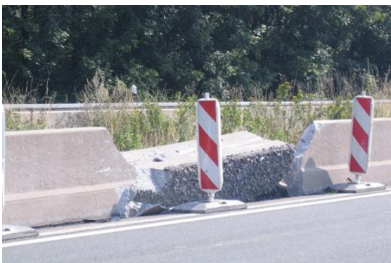
Ungeprüfte Schutzeinrichtung auf der A 4
